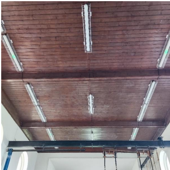
Nové LED osvětlení v malé tělocvičně
